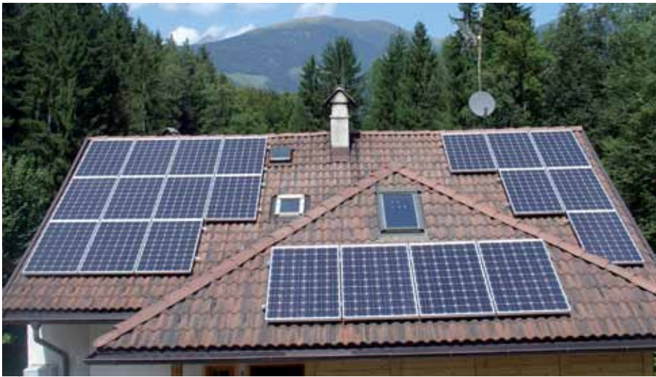
Elpo | Ehrenburg - Allemagne Installation: 5,04 kW | Système de crochets de toit
